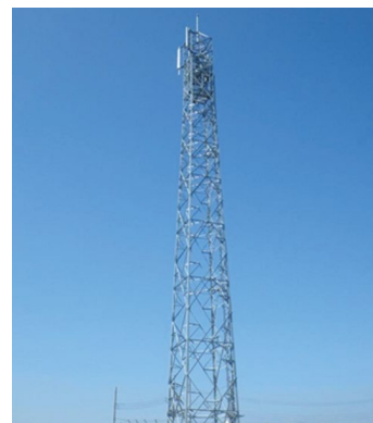
実際の移動通信ネットワーク装置
