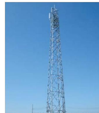
実際の移動通信ネットワーク装置
