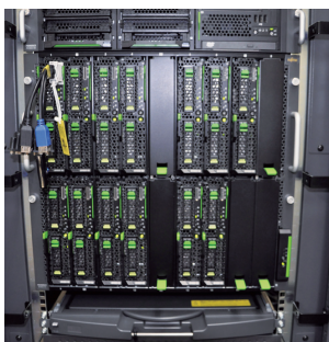
ブレードサーバ
